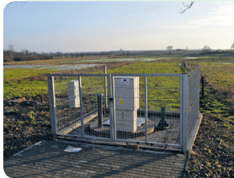
Przepompownia ścieków w Kukowie
